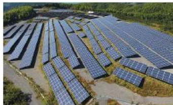
周南第1発電所 システム容量:2,313Kw
