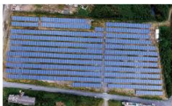
油谷発電所 システム容量:1,990Kw
