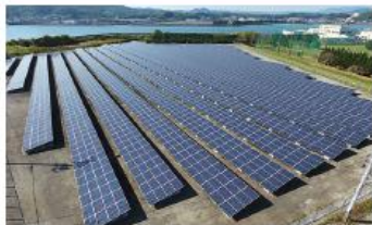
平生曾根第1発電所 システム容量:1,281Kw
